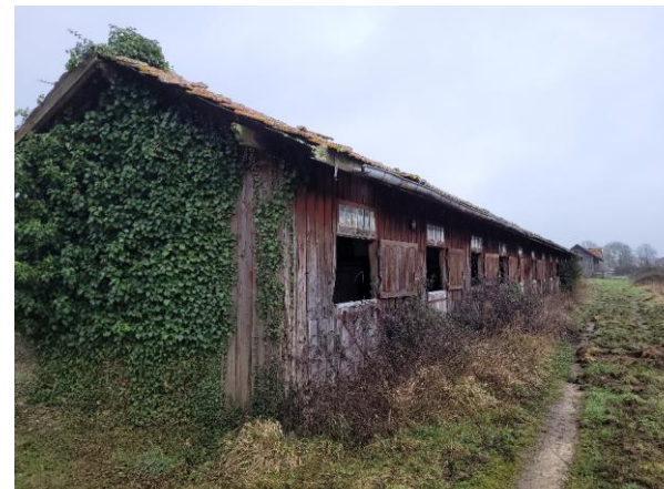
Bâtiment en bois en mauvais état démolit dans le cadre du projet
